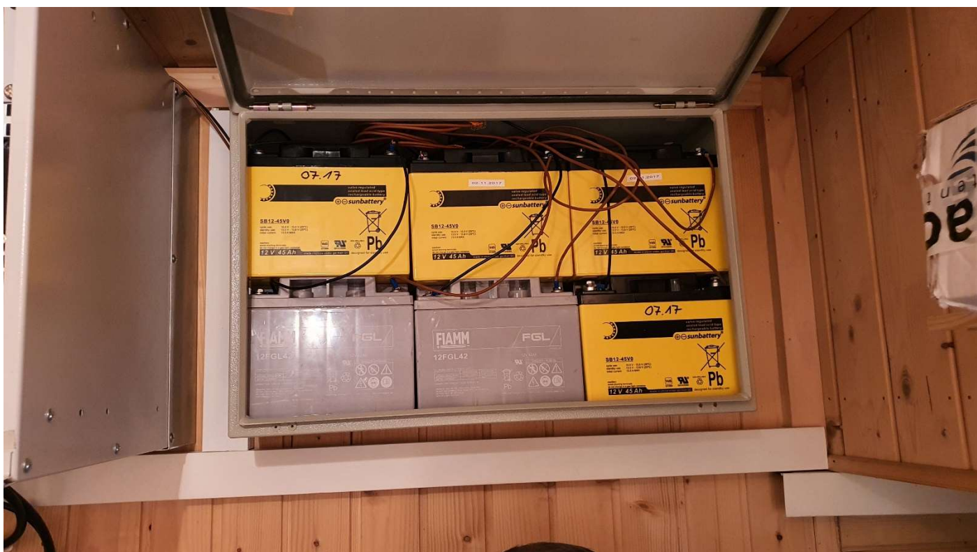
Bei Stromausfall kann der Betrieb tagelang aufrechterhalten werden.
