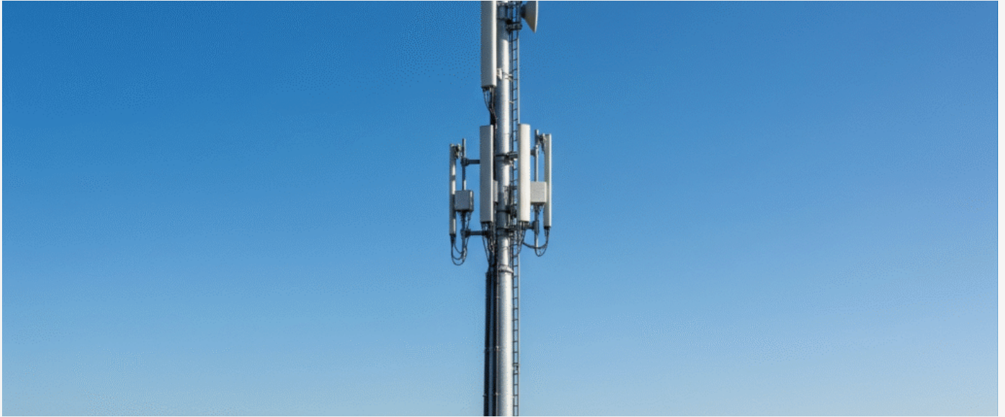
72-Stunden-Notstromversorgung von Handyantennen wird nicht umgesetzt
