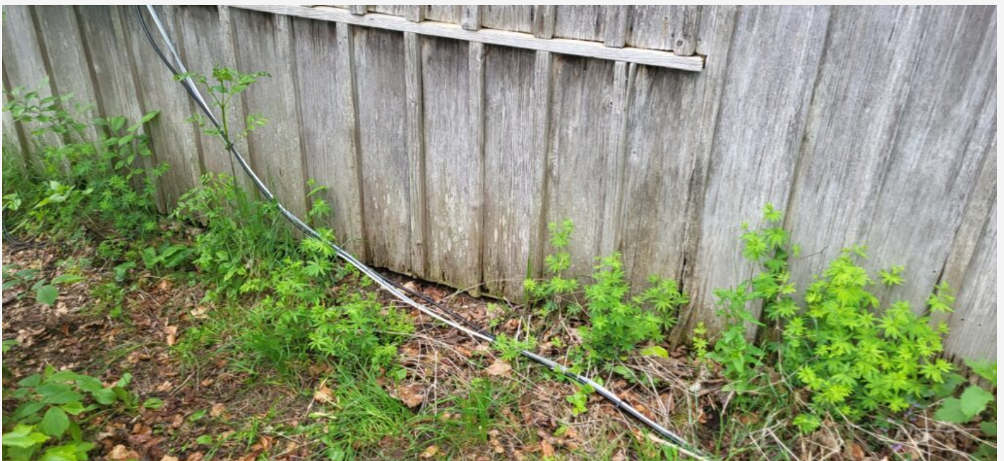
Kabel zur Loop
